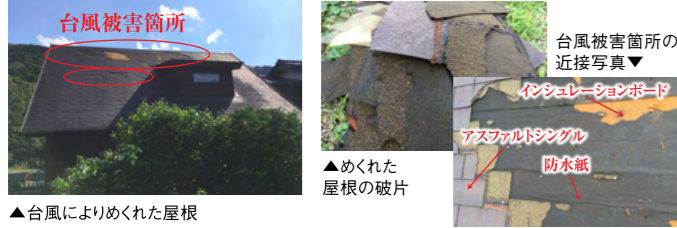
▲台風によりめくれた屋根
